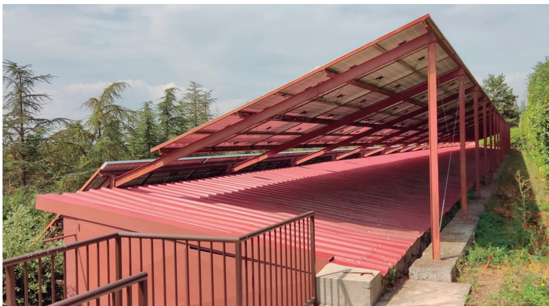
Figuras 4a y 4b. Instalación de paneles fotovoltaicos en edificios auxiliares de dos complejos monásticos históricos: arriba el monasterio cisterciense de Santa María de Poblet en Tarragona (Patrimonio Mundial), donde los paneles solares están sobre una construcción contemporánea de cubierta plana y exenta del edificio; abajo la Cartuja de Santa María de Miraflores en Burgos (Bien de Interés Cultural), donde se colocan en otro edificio sin valor patrimonial al Oeste, no visible desde el acceso por una barrera vegetal y que no interfiere en la contemplación del bien. Fuente: GoogleEarth.
